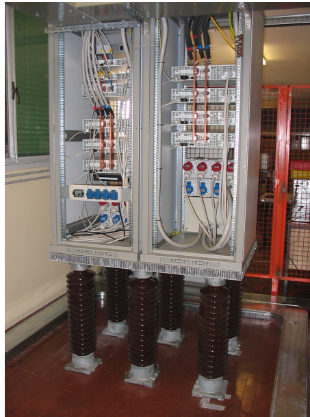
Figura 2.18: Vista dei rack contenenti tutti i dispositivi aventi un potenziale di 30kV .
