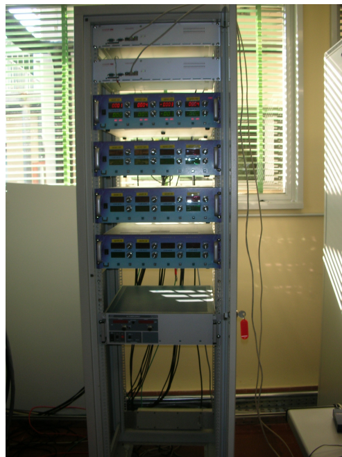
Figura 2.19: Vista del rack contenente i sistemi di controllo e di alimentazione per il deflettore, il tripletto di quadrupoli ed il blocco estrattore.
