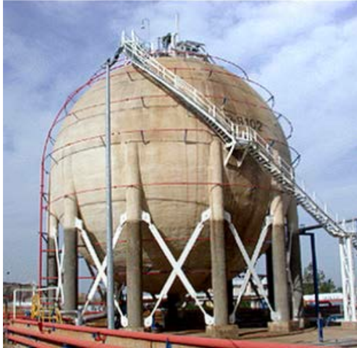
Figura 9.1.1: Serbatoio sferico nella raffineria di Aspropirgos (Grecia), metodo di Horton.
