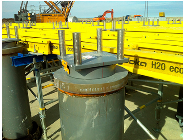
Figura 9.1.2: Apparecchi d'appoggio sferici fissi installati alla testa dei pali di fondazione.
