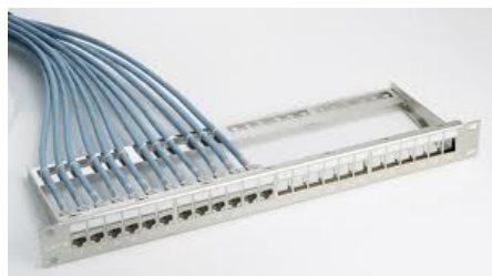
Figura 2.34: Sezione di cablaggio in patch panel
