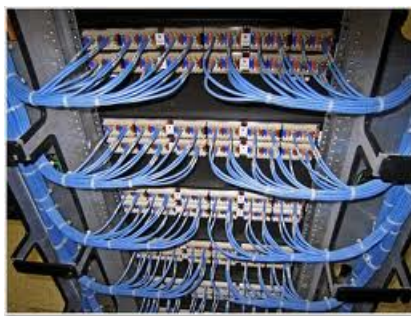
Figura 2.36: Patch panel montati su rack
