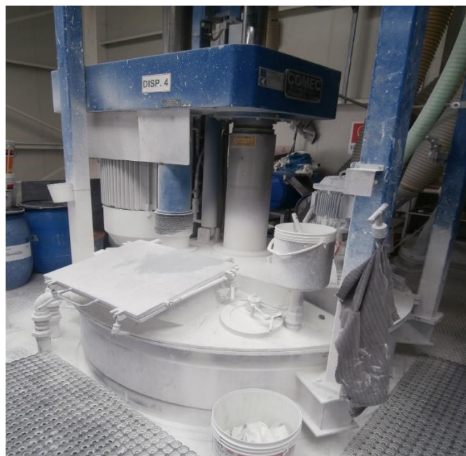
Figura 3.6 - Vista della parte superiore di uno dei due dispersori presenti nel Reparto Nuovo.
