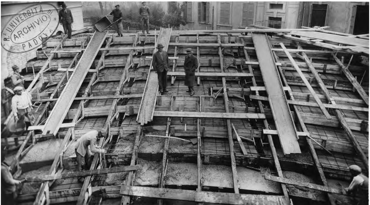
Figura 1.31: Aula gradonata con operai al lavoro in fase di getto con banchinaggio completato. Archivio Generale di Ateneo dell'Università di Padova, Fototeca dei Consorzi Edilizi.
