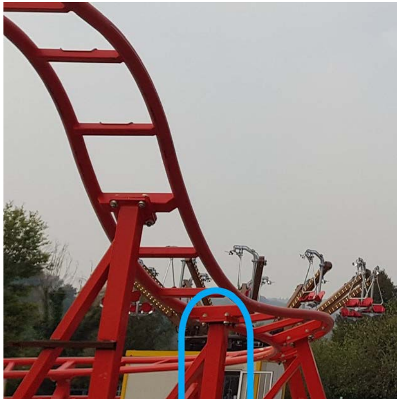
Figura 3.4: Curvatura al termine della prima discesa, evidenziata in azzurro la colonna C3
