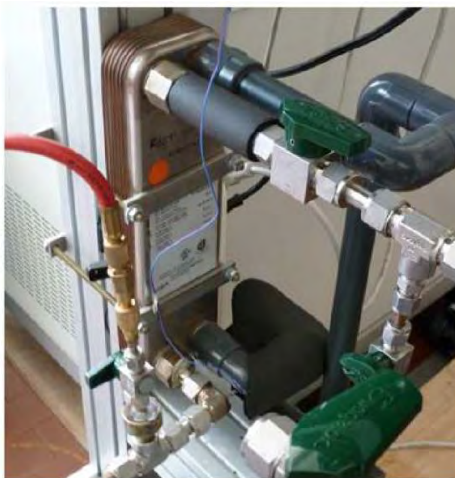
Figura 3.9: il circuito secondario dell'acqua fredda: il postcondensatore. Fonte: Salvatore [4].
