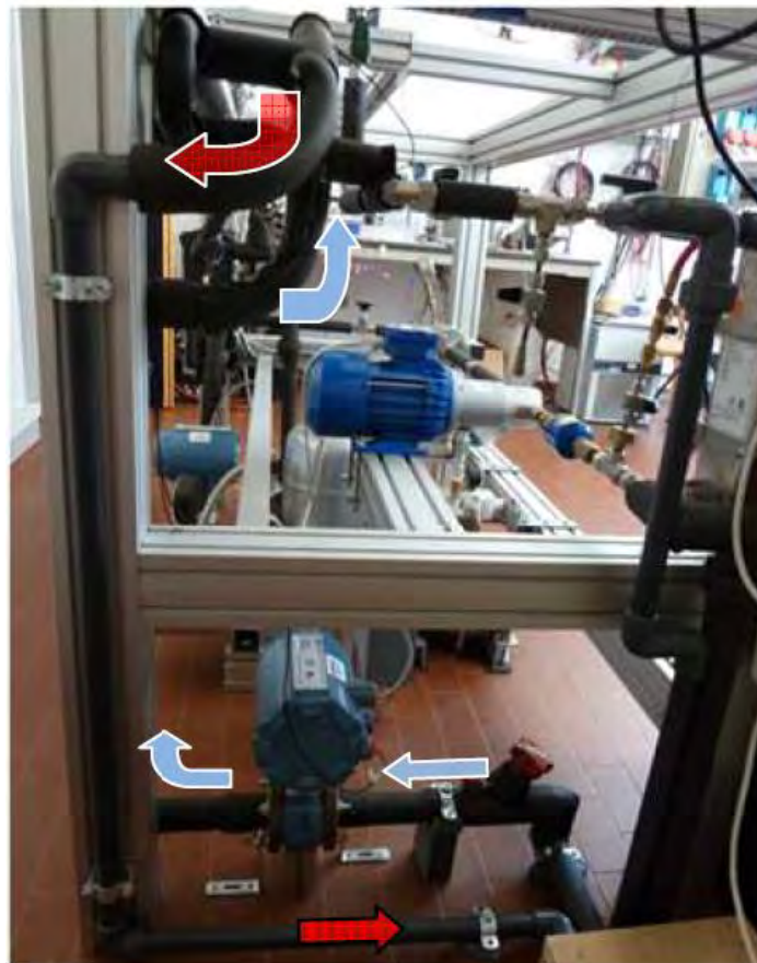
Figura 3.8: il circuito secondario dell'acqua fredda: il precondensatore. Fonte: Salvatore [4].
