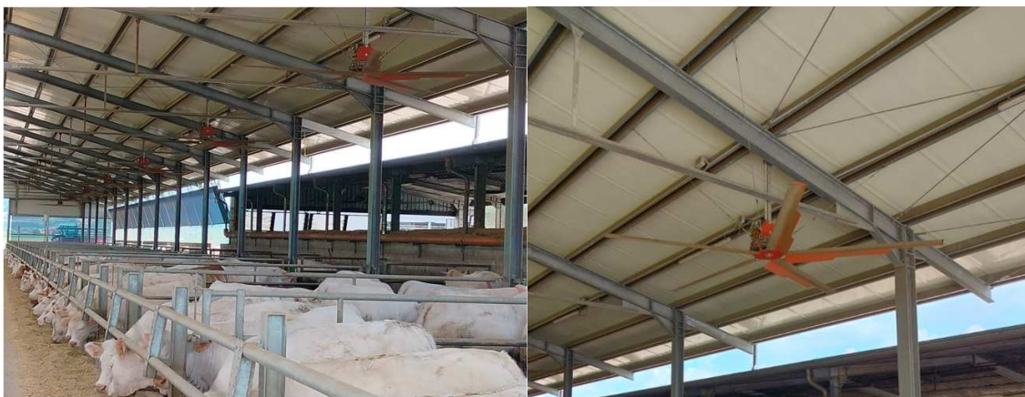
Foto 8: esempio di un sistema di ventilazione forzata, con flusso dell'aria verticale, in un allevamento intensivo a Vicenza, per gentile concessione del Dott. Davide Marcazzan
