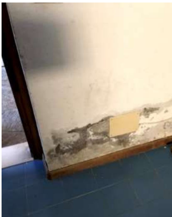
Fig. 2.7 presenza di umidità da risalita
