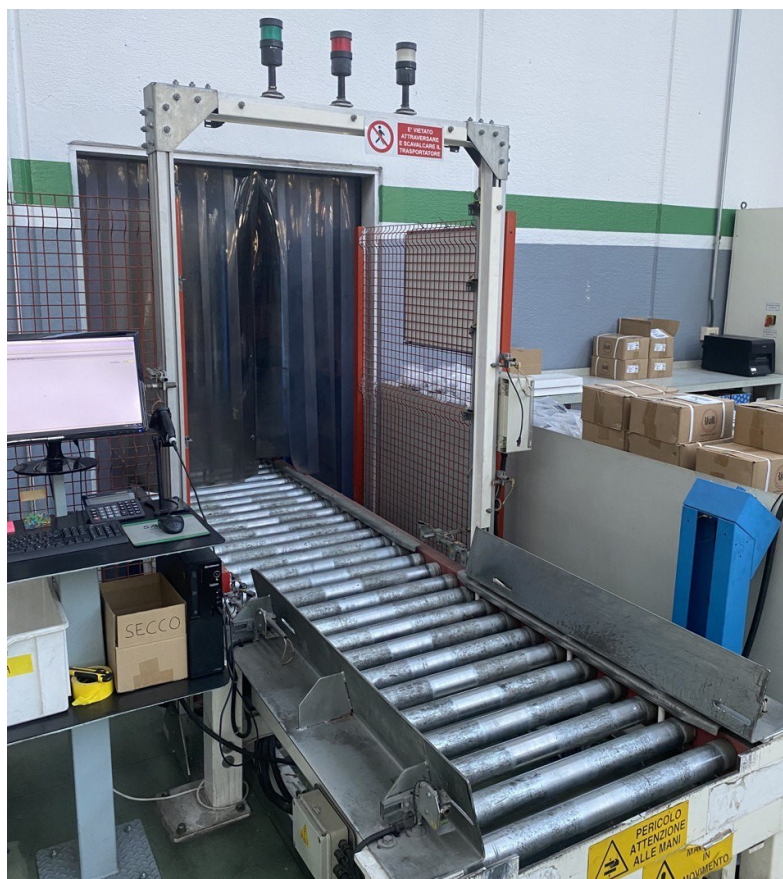
Figura 3.9: Gate di controllo sagoma di SARIV s.r.l.
