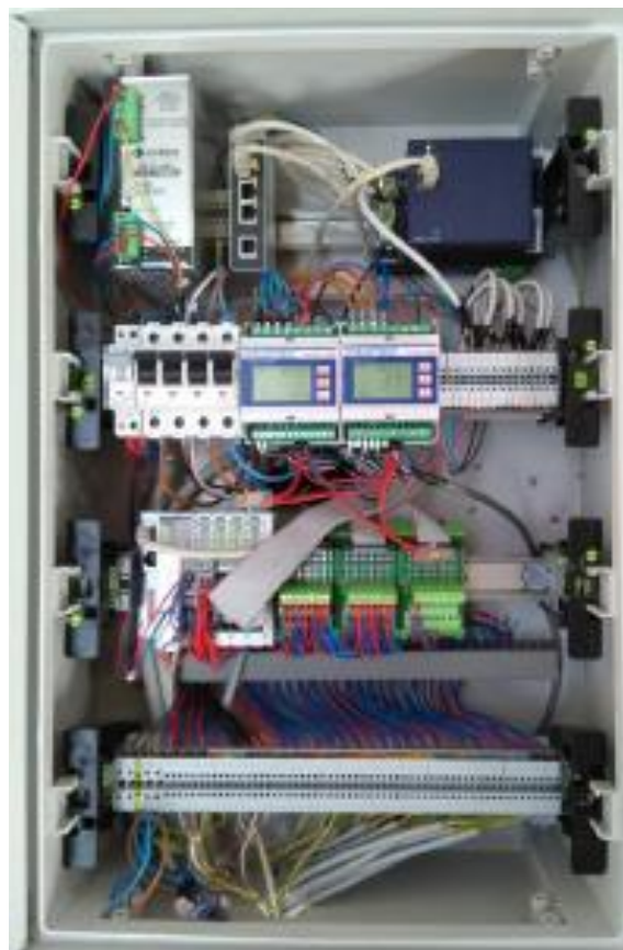
Figura 3.32 Quadro elettrico installazione sonde e acquirente dati eWon (box blu in alto sulla destra).
