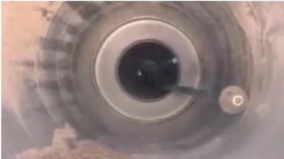
Figura 7.7 Testina ad aria compressa in azione in un condotto aria. Metodo di pulizia brevettato da A.R.I.A S.p.a.
