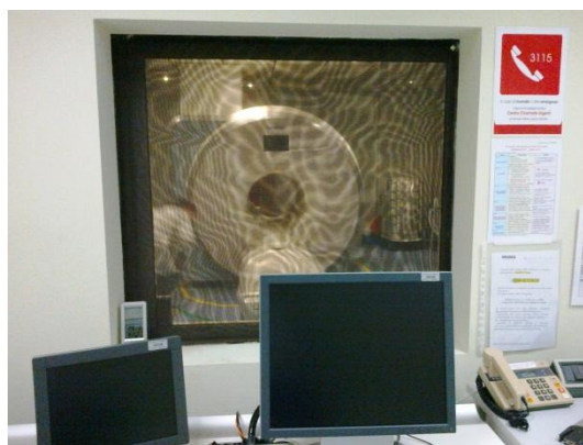
Vista della sala di controllo. In primo piano i pc di comando e per il monitoraggio del paziente, mediante collegamento alla videocamera interna al magnete. Si nota sulla destra la procedura da seguire in caso di emergenza.
