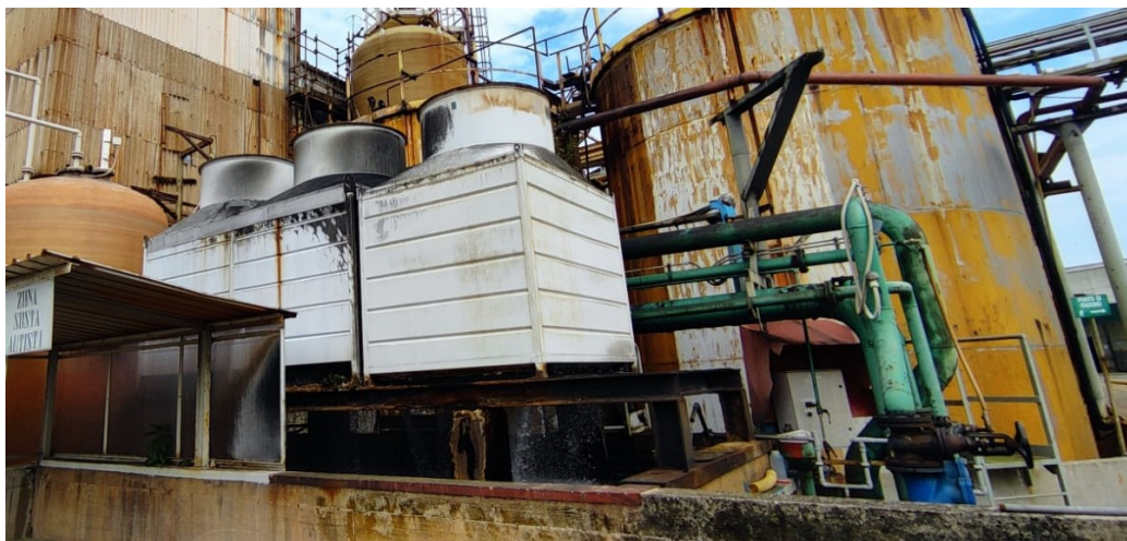
Torri evaporative del circuito di raffreddamento
