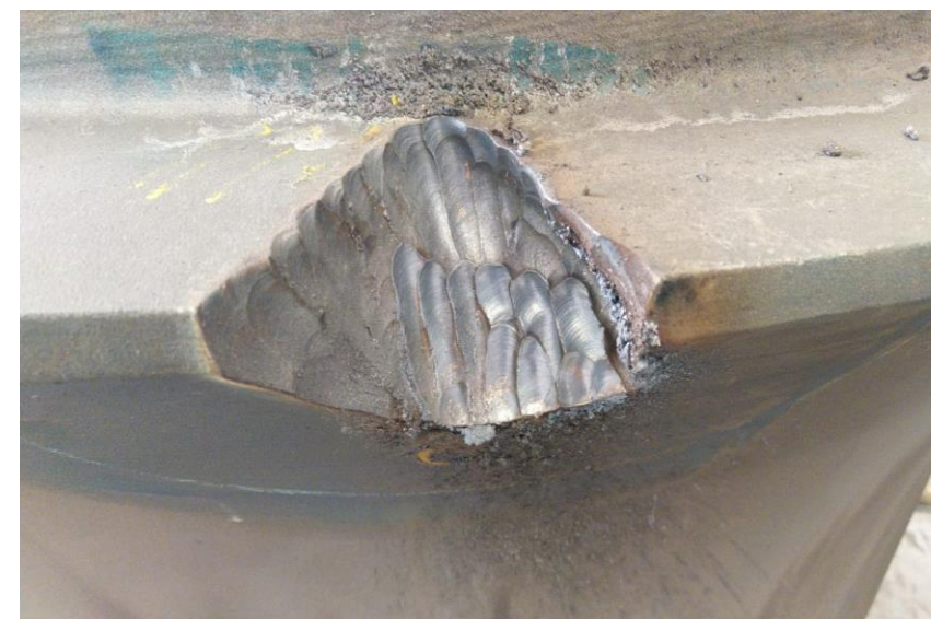
Scavo del difetto
