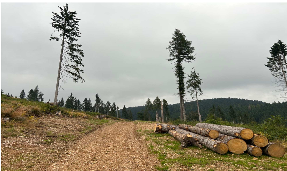
Figura 3.24 – Parte iniziale della pista di esbosco “Postesina – Marcadei” dopo i lavori di ripristino. Si nota ai lati della pista terreno movimentato con orizzonte minerale in superficie e ai lati piante singole di abete e un larice in centro (Foto di Michele Nicolussi Neff scattata il 01 agosto 2023 – loc. Marcadei)
