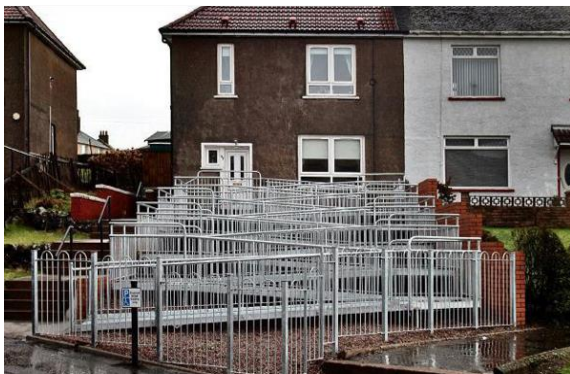
Figura 2: Questa rampa di scale a zig-zag è stata installata come modifica alla costruzione originale, ed è un esempio di cattivo design (Kalbag, 2017).
