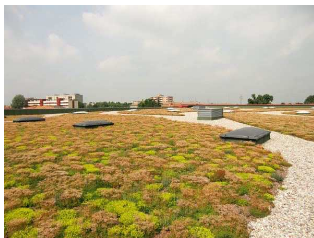
Fig. 6.12. Inverdimento estensivo Condominio EA7 Casanova con Climadrain 55 (Fonte Climagrün Srl - coperture a verde)
