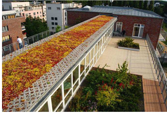
Fig. 6.9. Esecuzione resistente al vento attraverso griglie in calcestruzzo sul perimetro della copertura (Fonte Climagrün Srl - coperture a verde)
