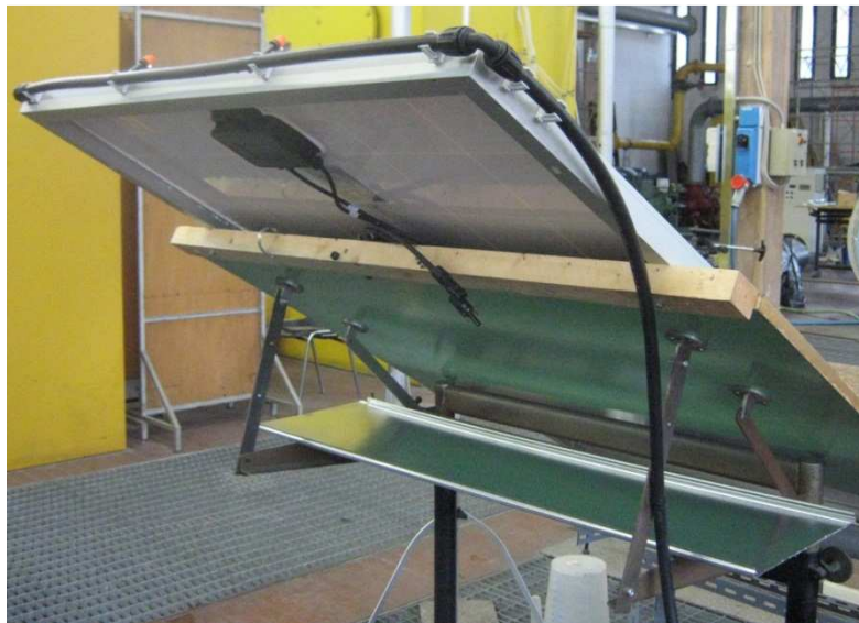
Figura 5.1: Particolare dell'installazione del pannello fotovoltaico presso il Dipartimento di Ingegneria Industriale
