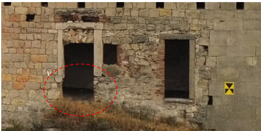
Figura 2.32. Dettaglio v degli elementi di dissesto nel prospetto ovest del palazzo.
