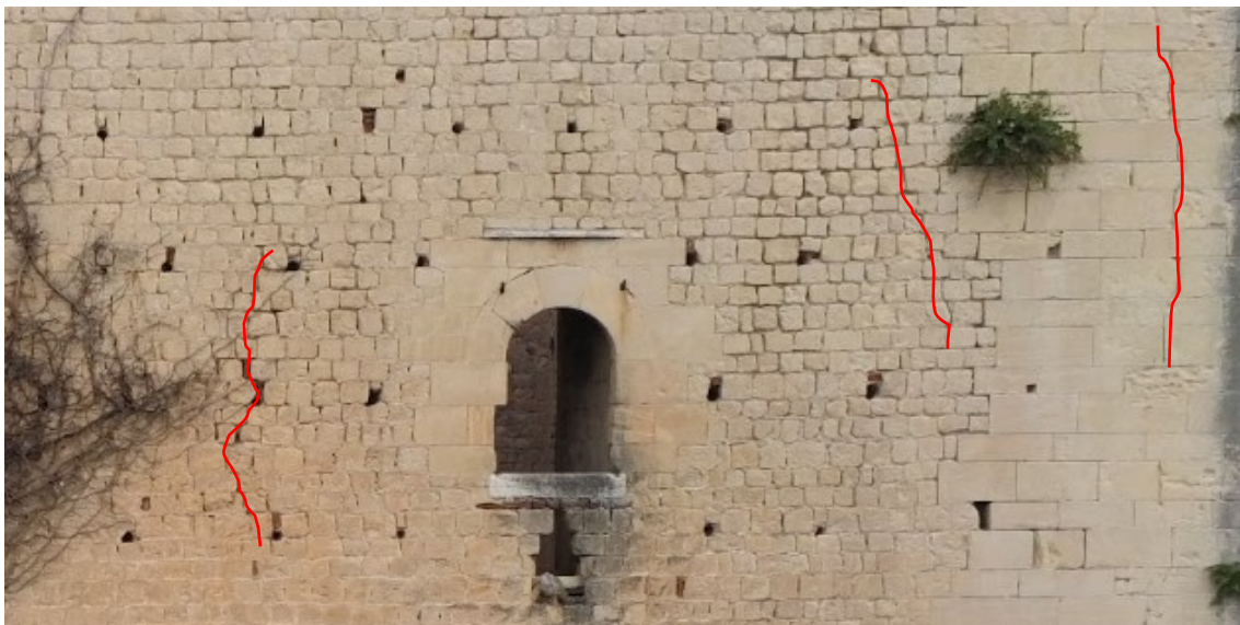
Figura 2.35. Dettagli iv, v, vi, vii degli elementi di dissesto nel prospetto sud del palazzo; nell'immagine sdoppiata sono indicate le fessurazioni più evidenti.
