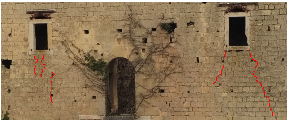
Figura 2.31. Dettagli i, ii, iii, iv degli elementi di dissesto nel prospetto ovest del palazzo; nell'immagine sdoppiata sono indicate le fessurazioni più evidenti.
