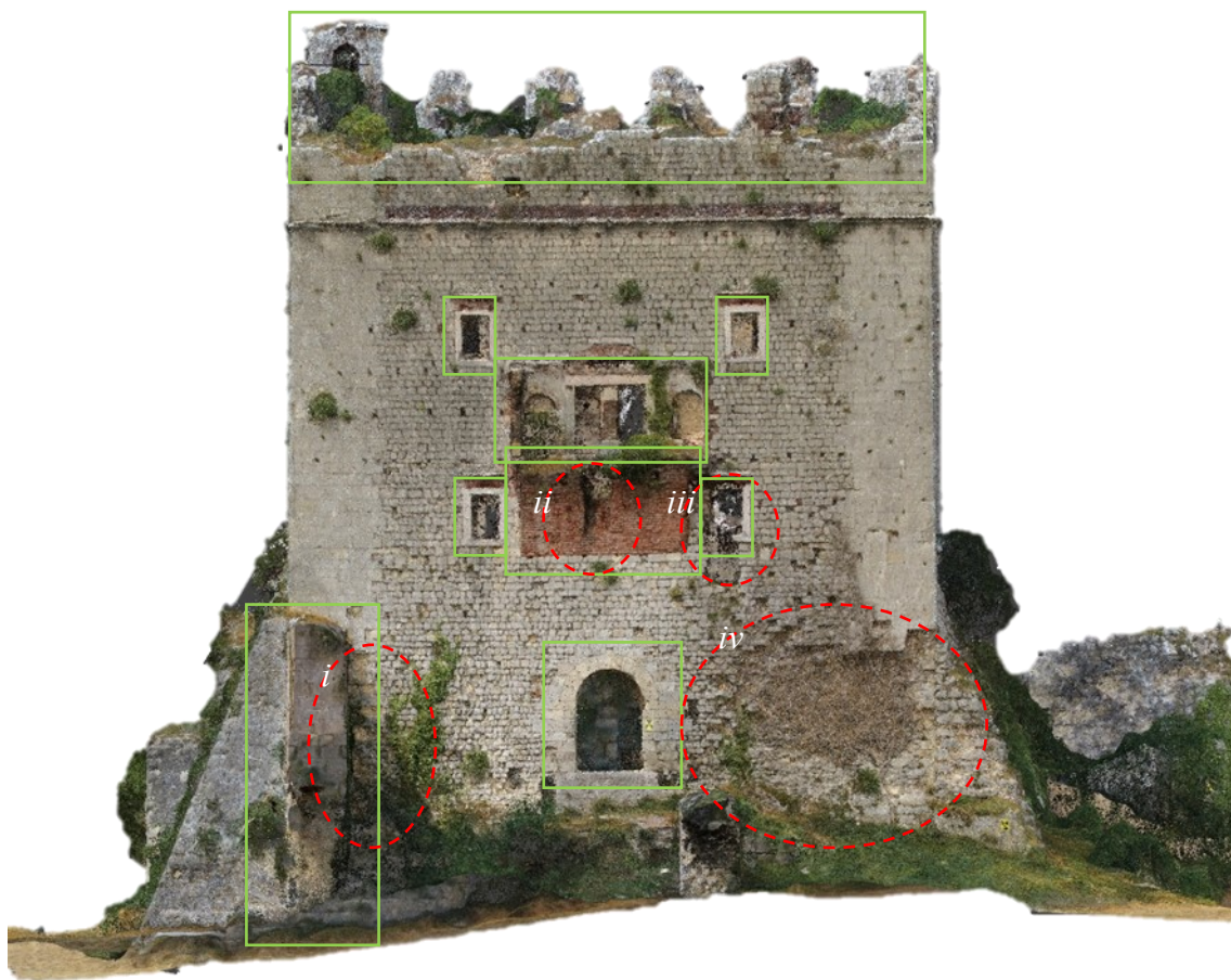
Figura 2.36. Elementi di dissesto e punti deboli nel prospetto est del palazzo.
