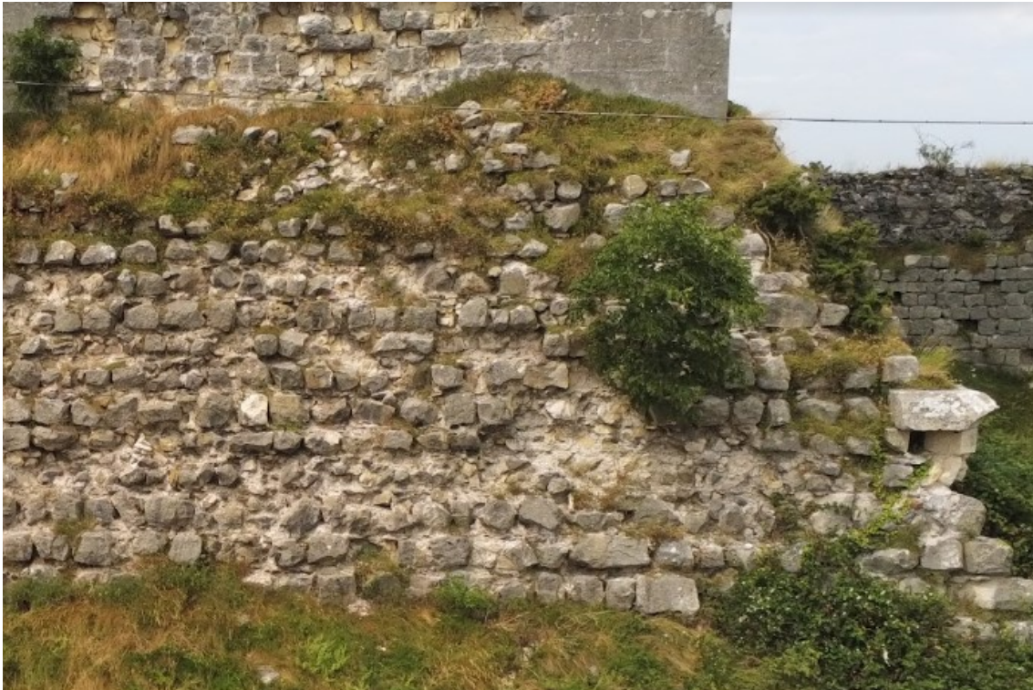
Figura 2.44. Particolare della disgregazione del paramento sulla scarpa e sulla parete verticale a est della torre.
