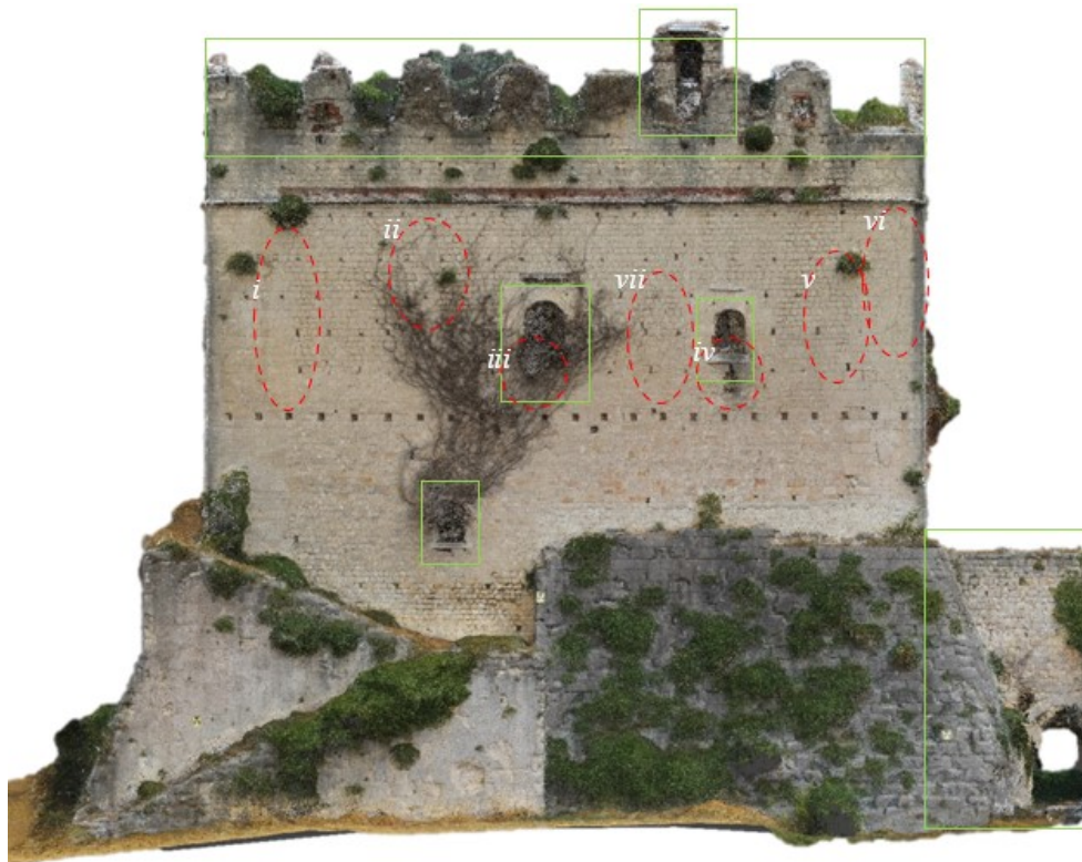
Figura 3.59. Elementi di dissesto nel prospetto sud del palazzo.
