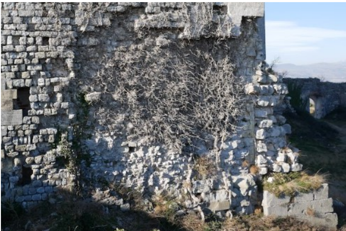
Figura 2.43. Particolare della disgregazione del paramento della parete verticale a est del palazzo.
