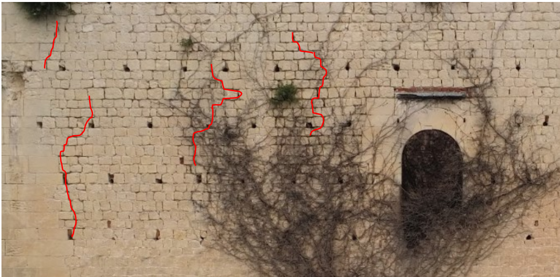
Figura 2.34. Dettagli i, ii, iii degli elementi di dissesto nel prospetto sud del palazzo; nell'immagine sdoppiata sono indicate le fessurazioni più evidenti.
