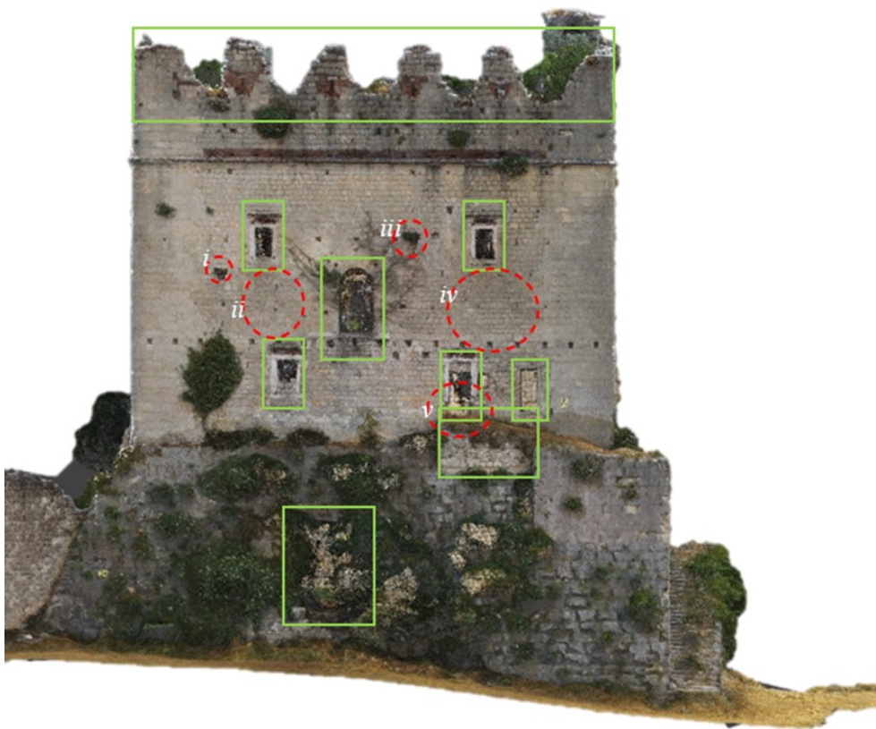
Figura 2.63. Elementi di dissesto nel prospetto ovest del palazzo.
