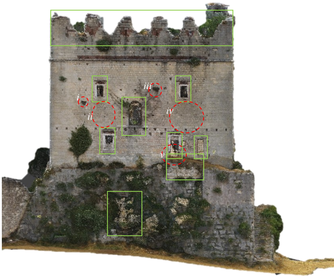
Figura 2.30. Elementi di dissesto e punti deboli nel prospetto ovest del palazzo.
