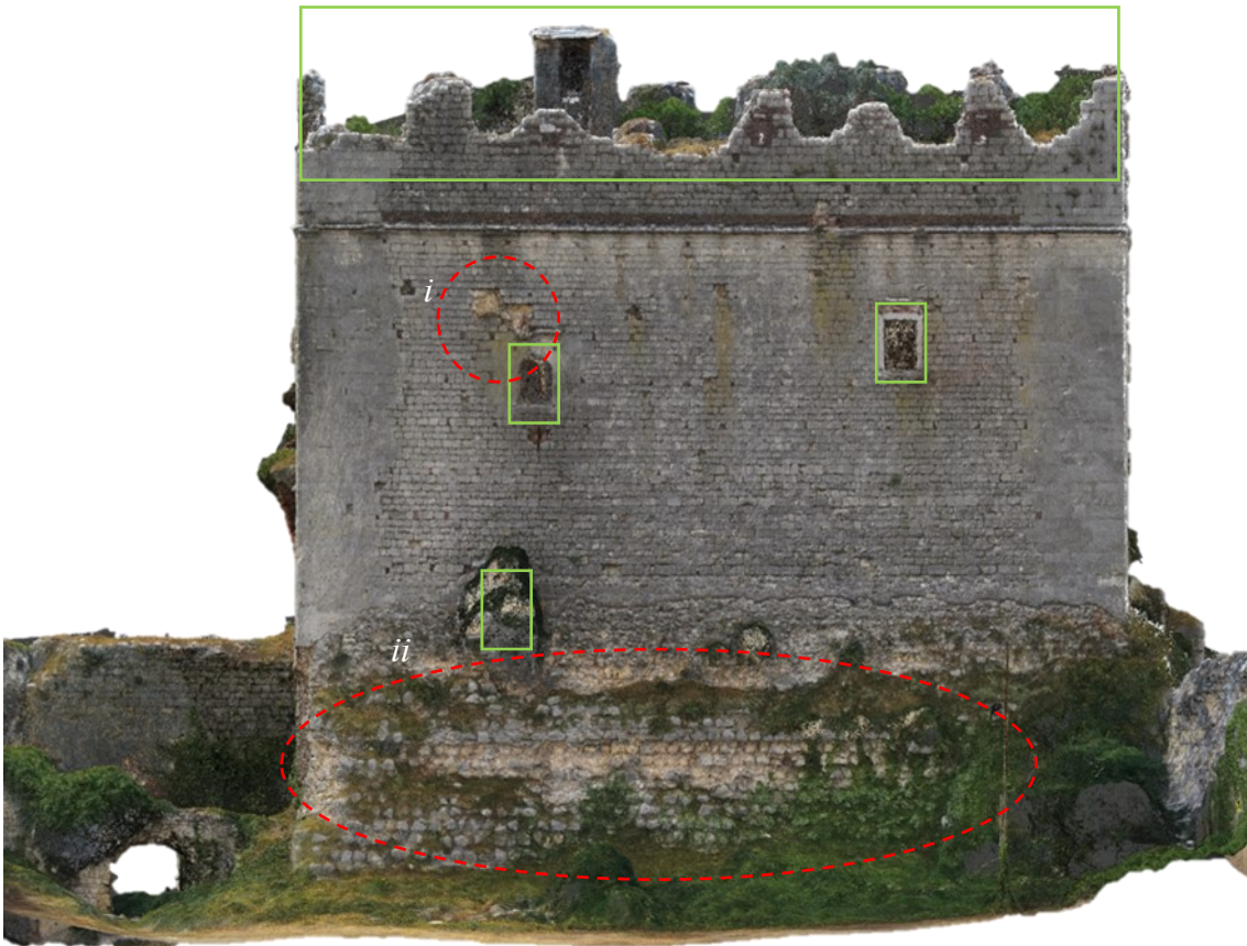
Figura 2.39. Elementi di disseto e punti deboli nel prospetto nord del palazzo.
