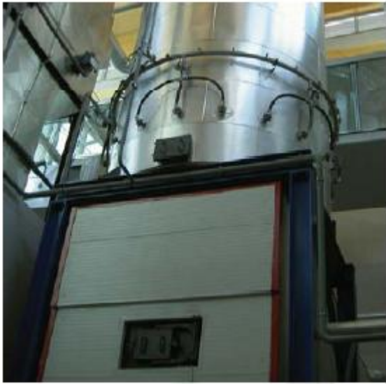
Caldaia a 10 MW
