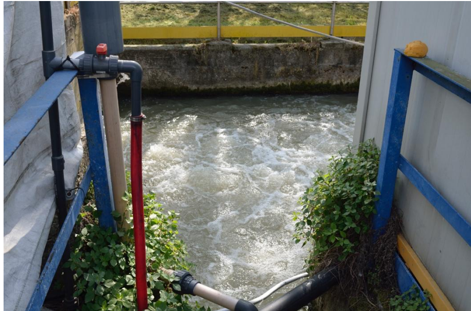
Figura 14. Acqua sottoposta ad areazione nell'impianto Bassette.
