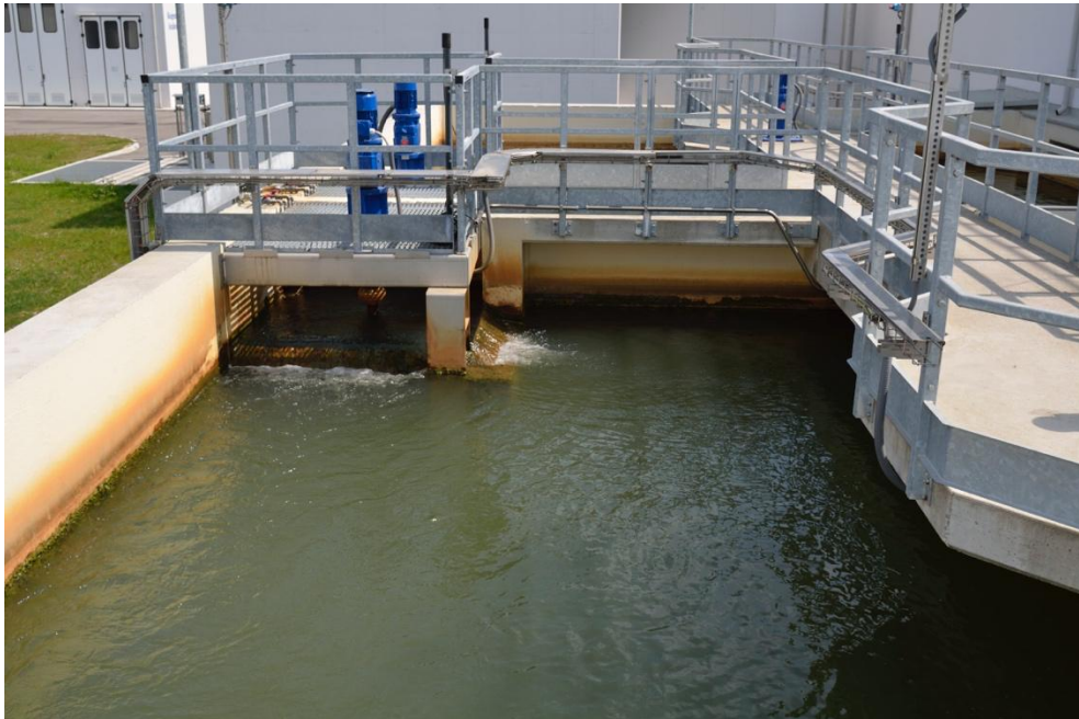
Figura 11. Vasca di flocculazione dell'impianto Standiana.
