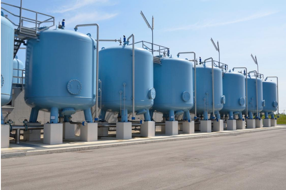
Figura 13. Filtri GAC/BAC dell'impianto della Standiana.
