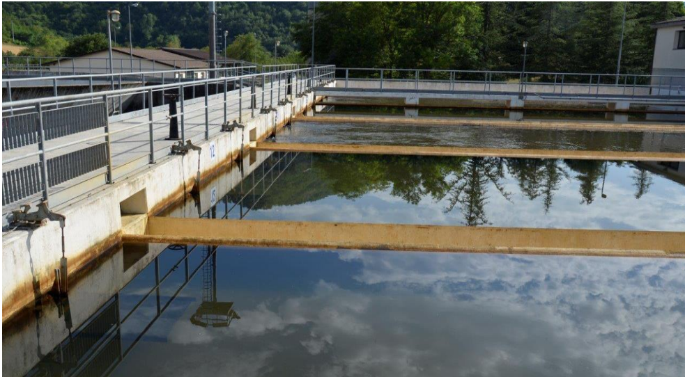
Figura 6. Filtri a sabbia relativi all'impianto di Capaccio.
