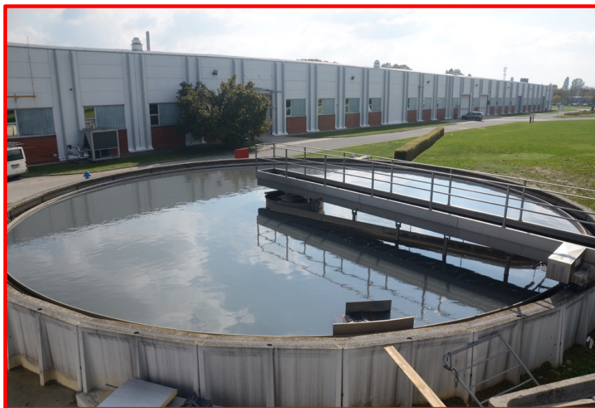
Figura 6. Vasca in cemento armato
