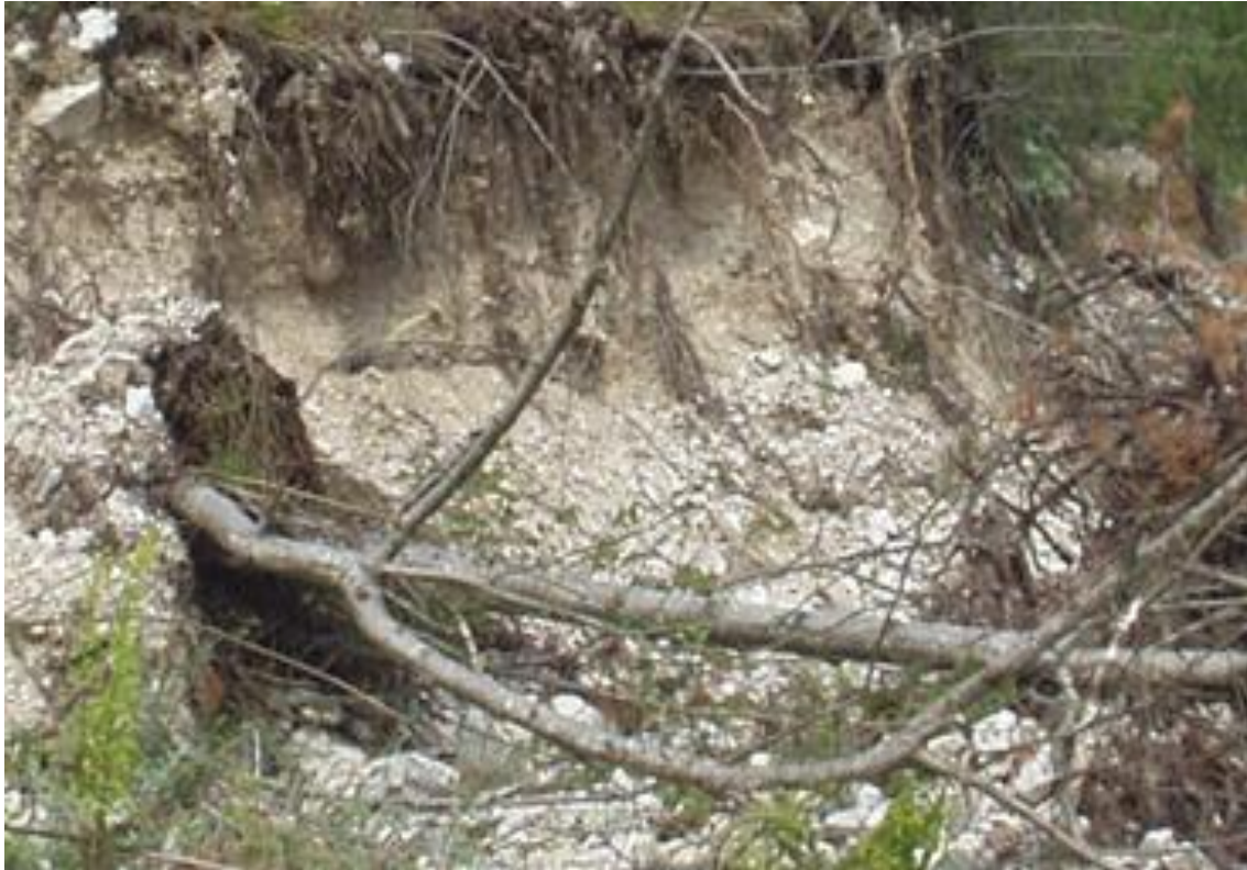
Fig. 6.22 Ceppaia caduta in alveo nel settore 4.
