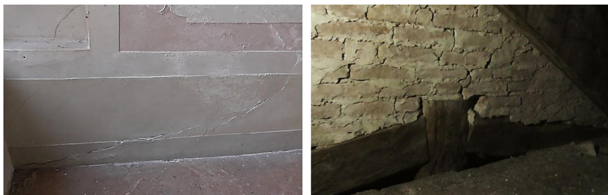
Fig. 9.20: Lesioni passanti nella stanza n° 154 al piano secondo e vista dal sottotetto laterale della stessa parete.
