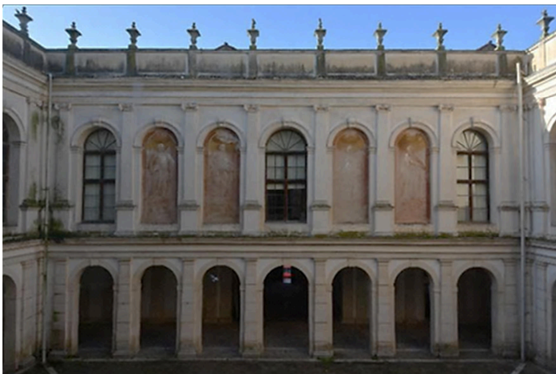
Fig. 8.17: Una delle facciate dei cortili, si può notare il degrado dovuto all'esposizione alle intemperie , nonché la variazione nelle tonalità di colore negli affreschi.
