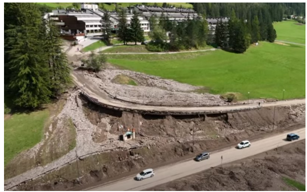
Figura 19. Erosione della strada di accesso alle strutture turistiche (Local Team)
