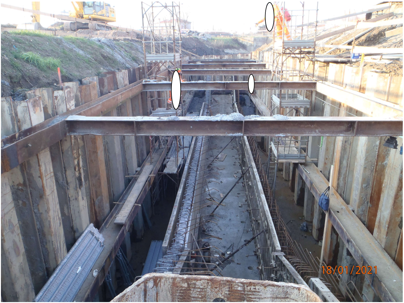
Foto 7 torri di discesa e risalita con palo pescante
