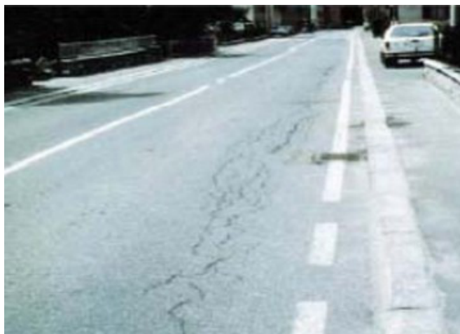
Figura 4.15 – Fessurazione Longitudinale e Ormaia
