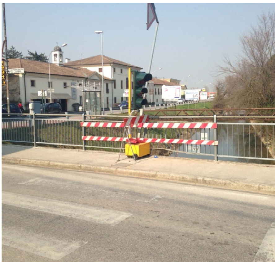
Figura 5.6 – Segnalazione di ripristino guardrail su SP 15 Bosco al km 0+000.
