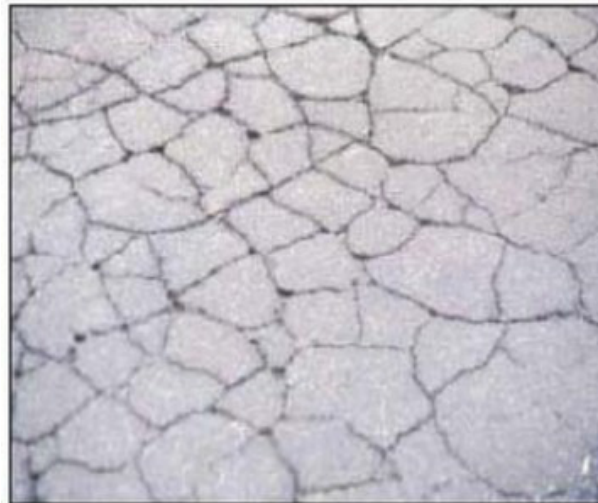
Figura 4.17 – Fessure a pelle di coccodrillo
