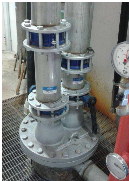
Figura 3.2 Tubazioni al pozzo
