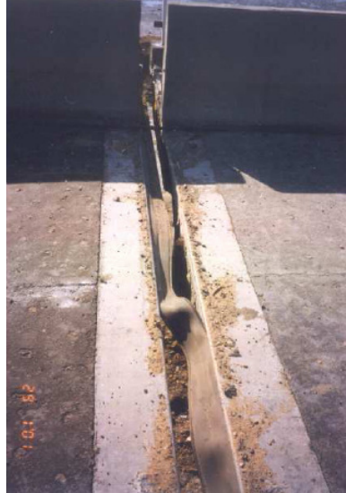
Figura 1-3: Danneggiamento di un giunto
