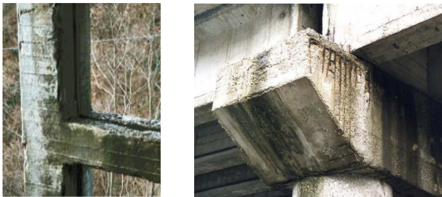
Figura 1-2: Pile da ponte soggette indirettamente all'azione dei sali disgelanti provenienti dal piano stradale
