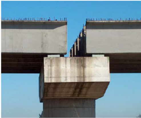
Fase 1: Preparazione inghisaggi traverso all'estradosso pulvino e infissione connettori all'interno delle travi
