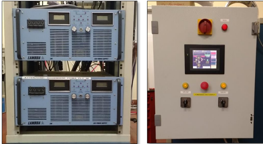
Figura 3.21: A sinistra i due alimentatori disponibili nel laboratorio HT, a destra l'interfaccia del PLC.
