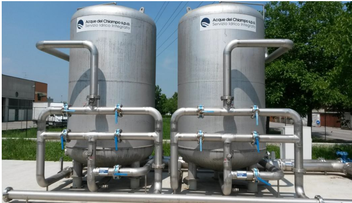
Fig 4: Impianto di filtrazione a carboni attivi granulari a Lonigo. (acquedelchiampospa.it)
