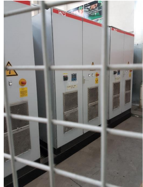
Particolare della cabina (2)
