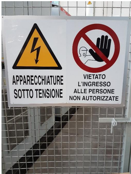
Particolare della cabina (1)
