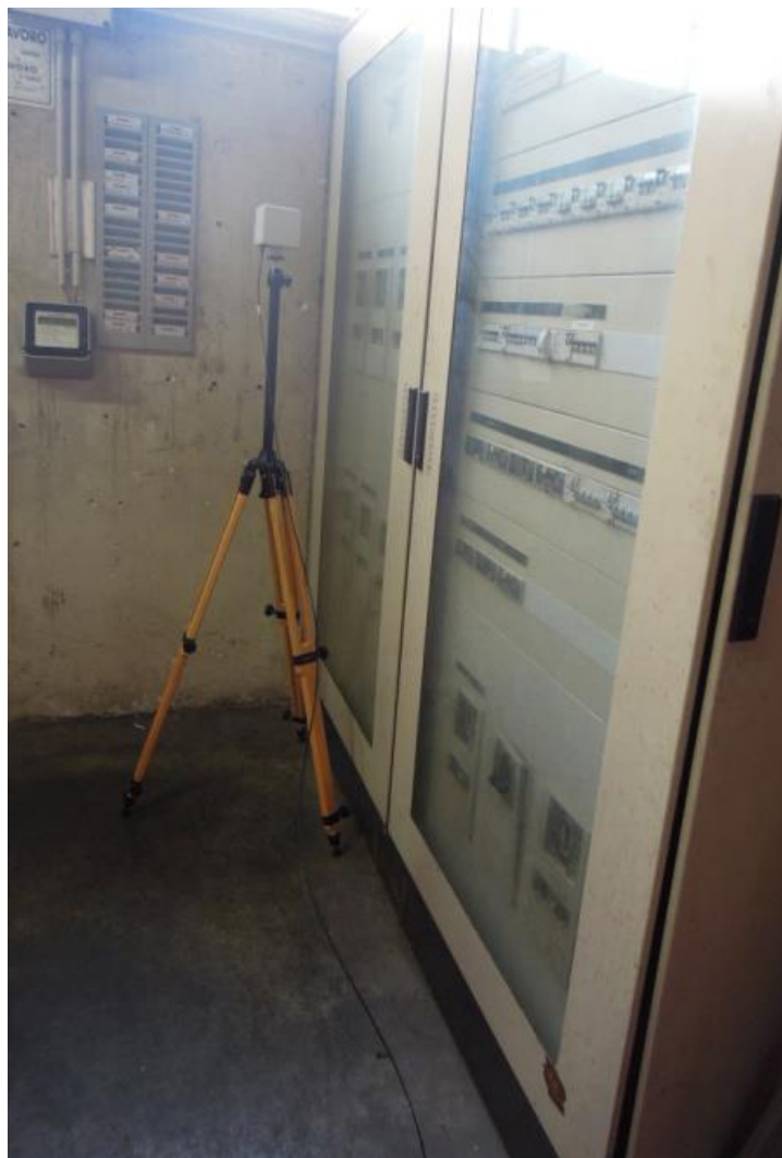
Particolare del quadro elettrico e posizionamento della sonda
