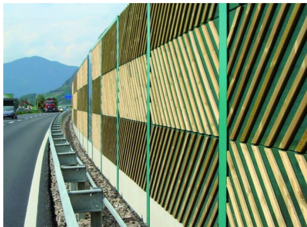
Figura 11 Barriera con pannelli in legno
