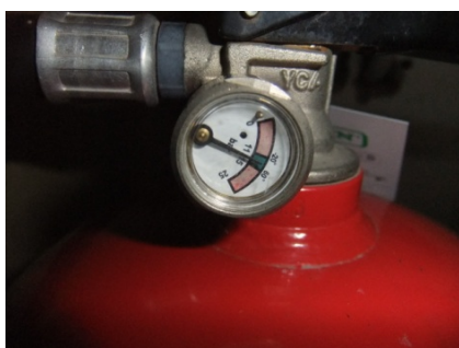
Figura 7.2 – Manometro di un estintore a polvere con indicazione nella zona verde
