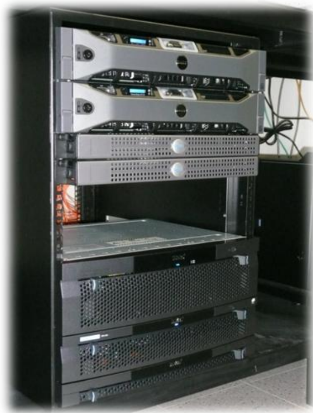
Fig. 2.3. Rack completo di Host, San e Switch in Fibra
