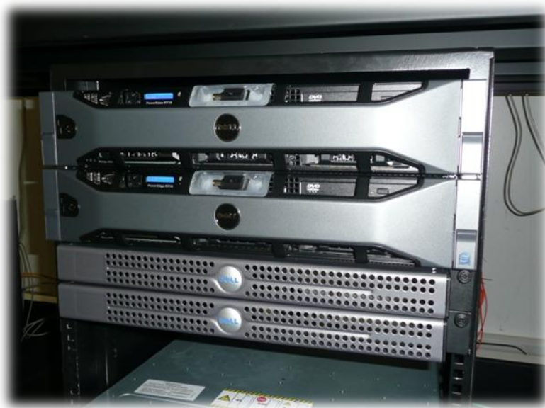
Fig. 2.1. Doppio server PowerEdge R710 con due switch in fibra ottica
