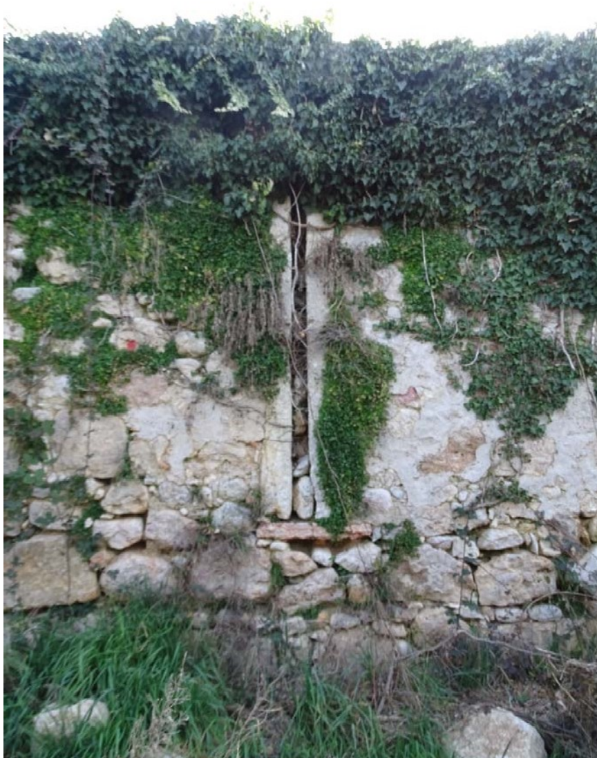
Figura 16: Chiavica presente in prossimità di località Campo Leon.
