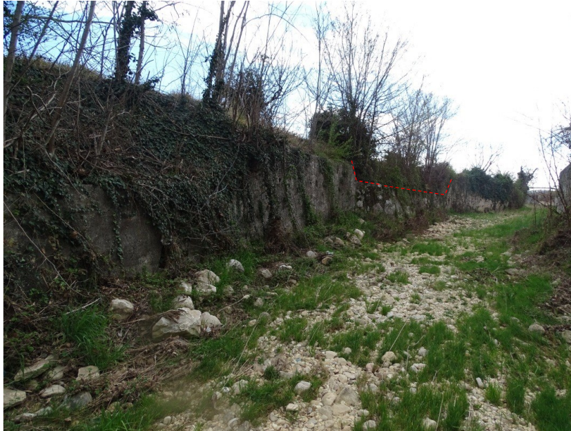
Figura 15: (D) Sfiatore in sinistra idrografica in prossimità di località di Campo Leon. La soglia di sfioro è stata chiusa da un argine di terra.
