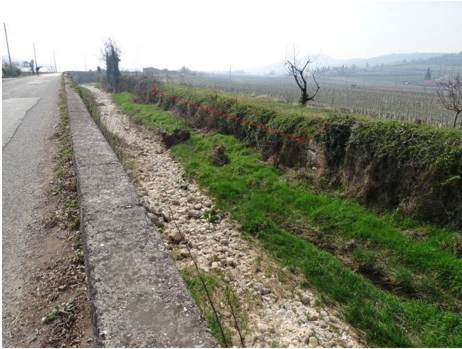
Figura 12: (A) Sfiatore in destra idrografica a valle dell'abitato di Mezzane.
