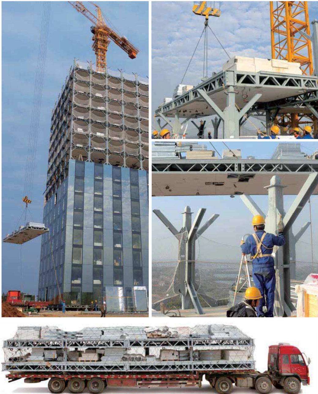
Figura 10: Alcune immagini dell'edificio di 30 piani realizzato dall'azienda cinese Board Group in 15 giorni
