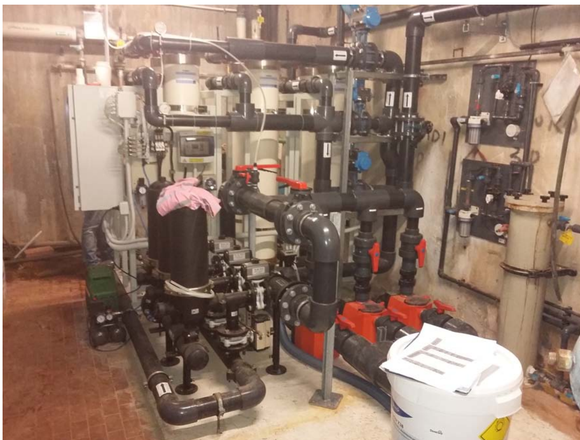
Figura 3.11: Impianto di ultrafiltrazione di un sito analizzato
