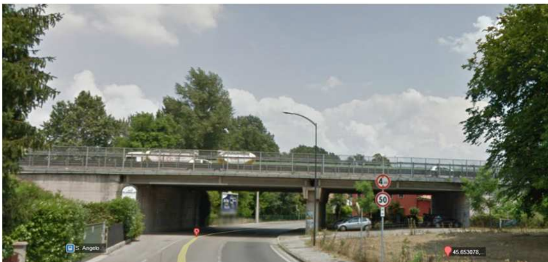
Figura 82 - Caso studio: ponte con danno medio più elevato, sulla tangenziale di Treviso (IBRID_ID 3393)
