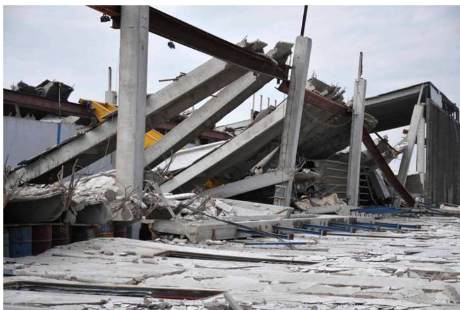
Figura 3 - Emilia Romagna, 20/5/12: crollo di un edificio industriale
