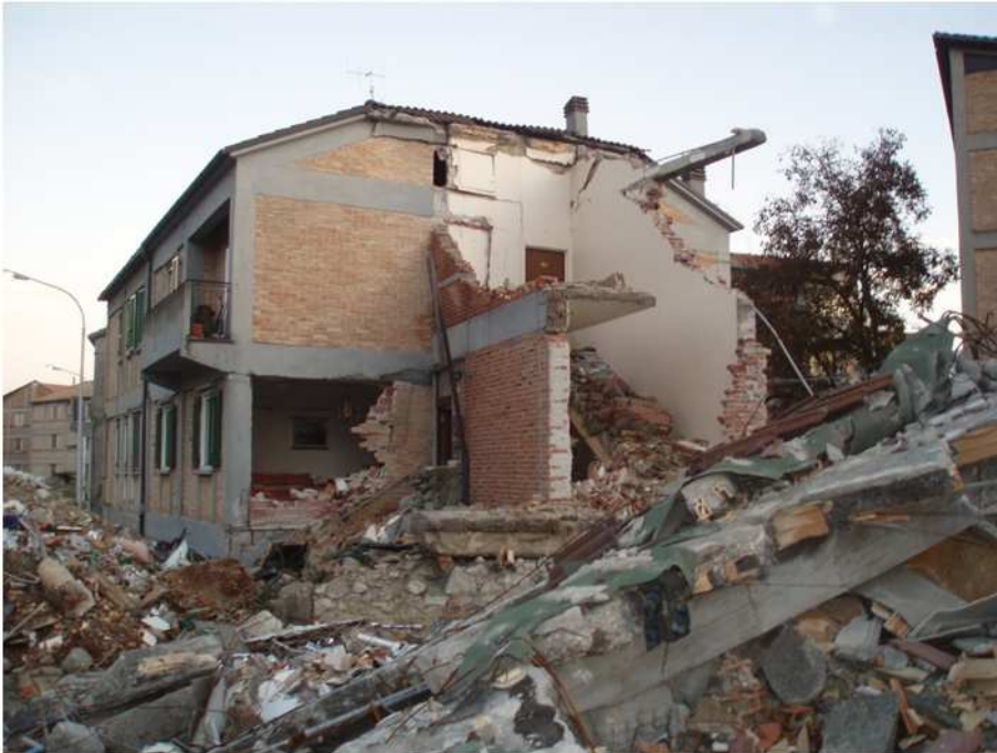
Figura 1 - L'Aquila, 6/4/09: crollo di un edificio residenziale
