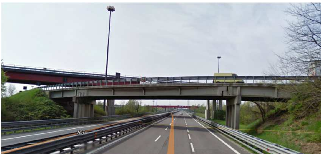
Figura 84- Caso studio: ponte danneggiato sulla rete autostradale (IBRID_ID 3038)
