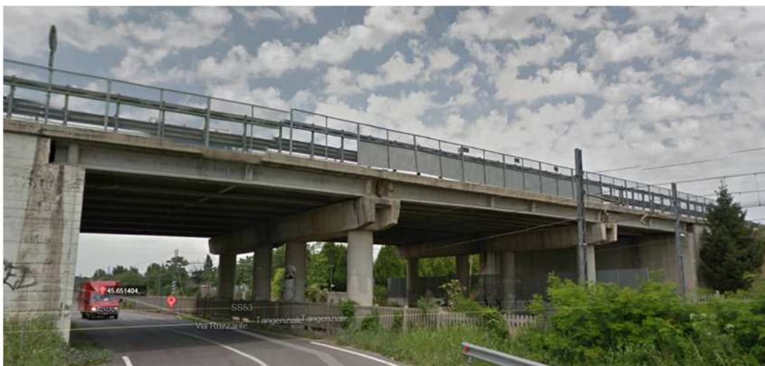
Figura 83 - Caso studio: ponte danneggiato sulla tangenziale di Treviso (IBRID_ID 3388)
