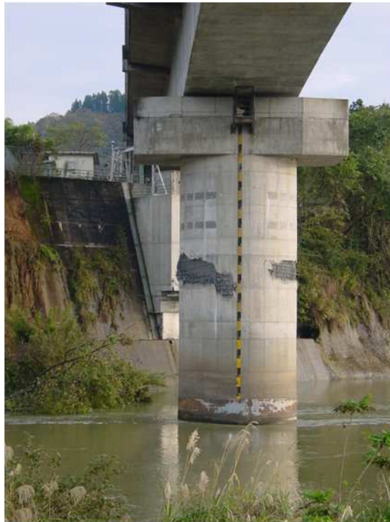
Figura 61 - Esempio di danno moderato
