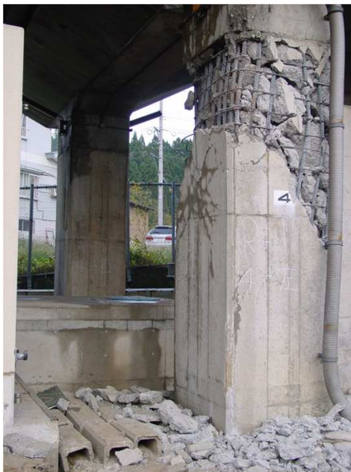
Figura 62 - Esempio di danno esteso
