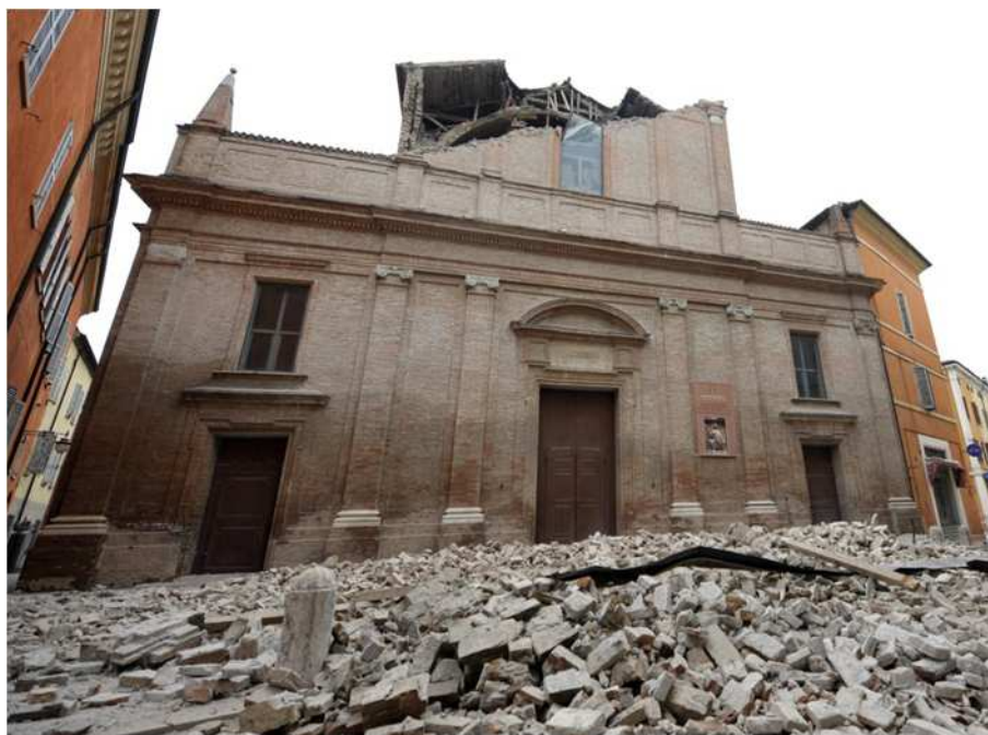
Figura 2 - Emilia Romagna, 20/5/12: edificio storico danneggiato
