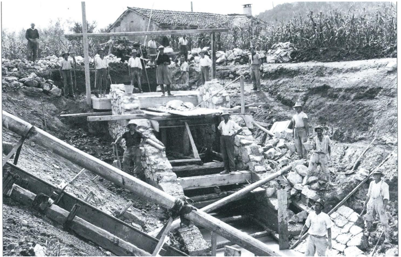
Galleria di bonifica per lo scolo delle acque a Sant'Agostino (Arcugnano).
