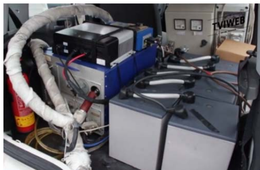
Figura 2.10: Dettaglio strumentazione [tvweb.it].
