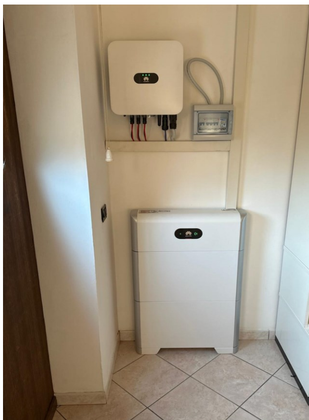
Figura 2.3: L'impianto composto da: inverter, batterie con BMS e quadro elettrico 25 .
