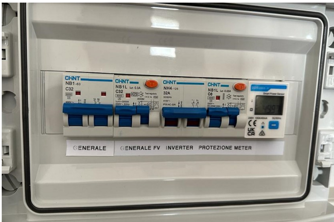
Figura 2.4: Quadro elettrico in AC dell'impianto 26 .
