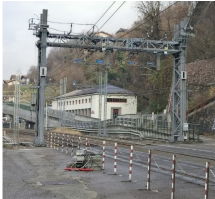
Figura 4.19 Portale TE su cui montare i DMBC
