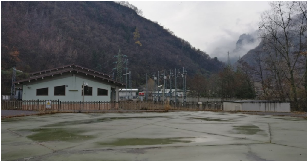
Figura 4.7 Sottostazione di alimentazione intermedia
