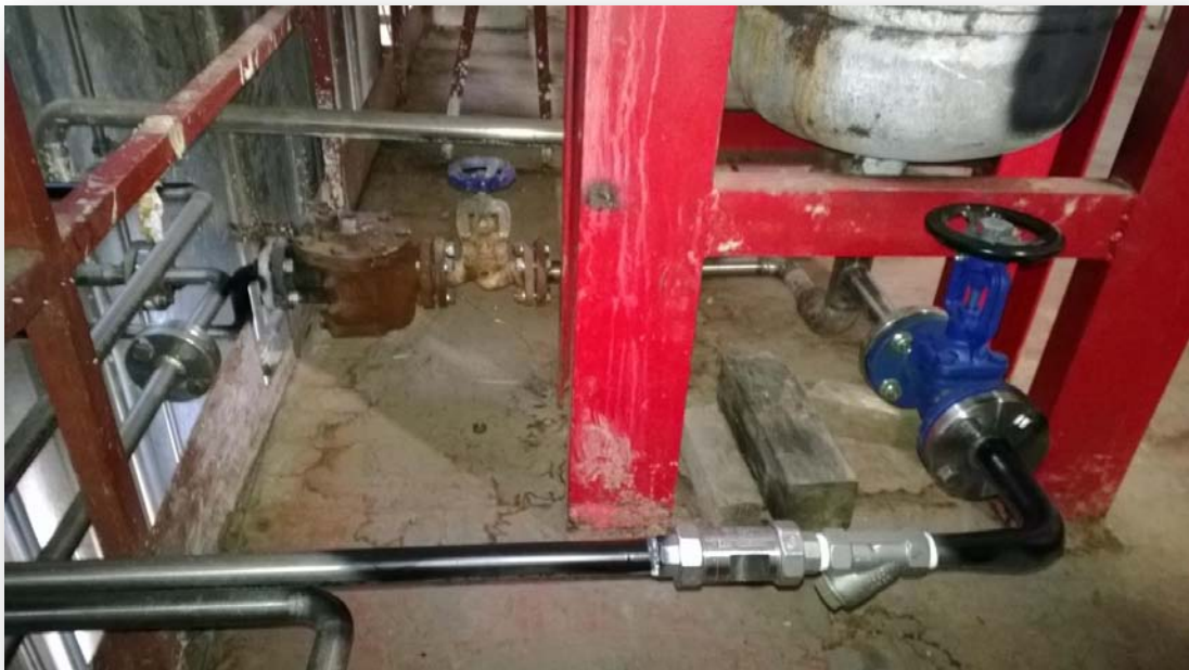
Figura 43: Foto dello scaricatori Venturi e secchiello rovesciato posizionati in parallelo sull'uscita del separatore di condensa.
