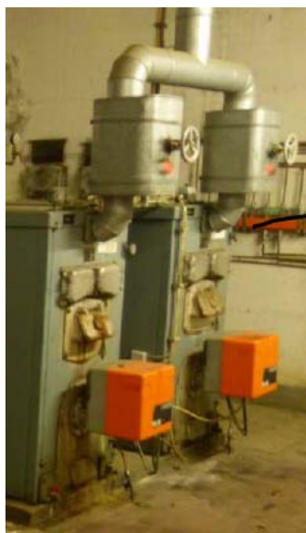
Figura 20: Gruppo caldaia più datato.
