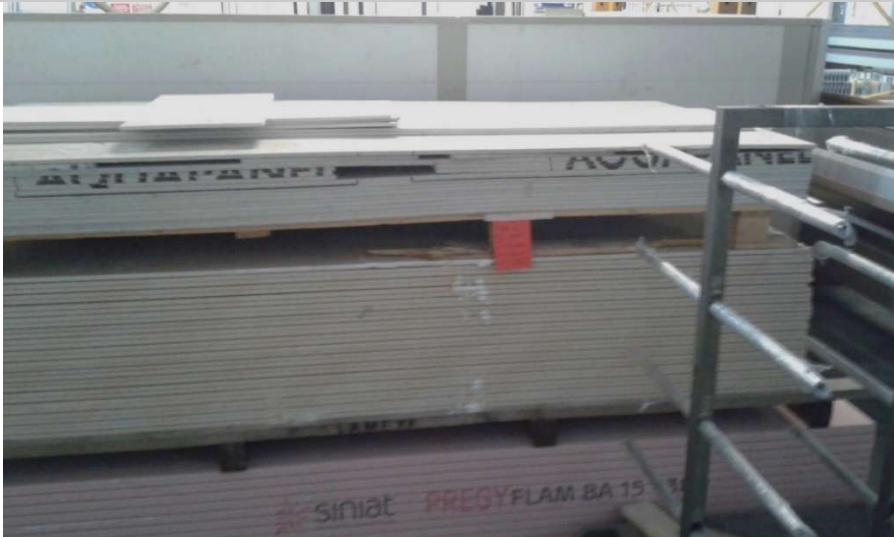
Cartongesso stoccato all'interno del reparto
