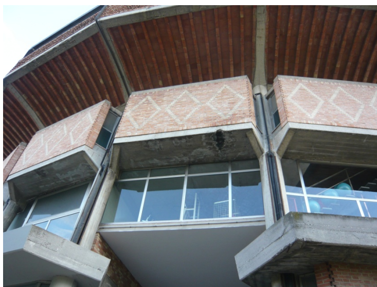
Figura 43: macchie sul calcestruzzo
