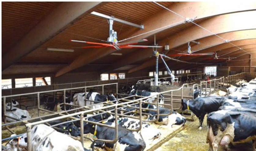
Figura 4.1: ventilatori HVLS collocati in zona di riposo (“CMP - Animal Welfare | Galleria fotografica e installazioni CMP,” n.d.).
