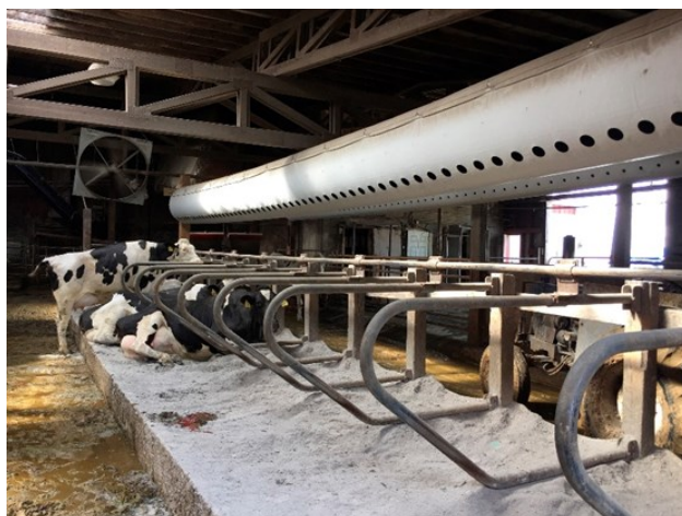
Figura 3.4: Sistemi di ventilazione a tubi a pressione positiva (Mondaca, 2019).
