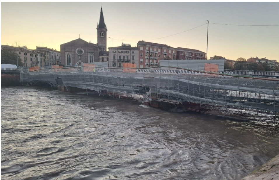
Figura 7: I ponteggi di Ponte Nuovo danneggiati a seguito dei detriti trasportati dall'Adige il 31 ottobre 2023, da L'Arena
