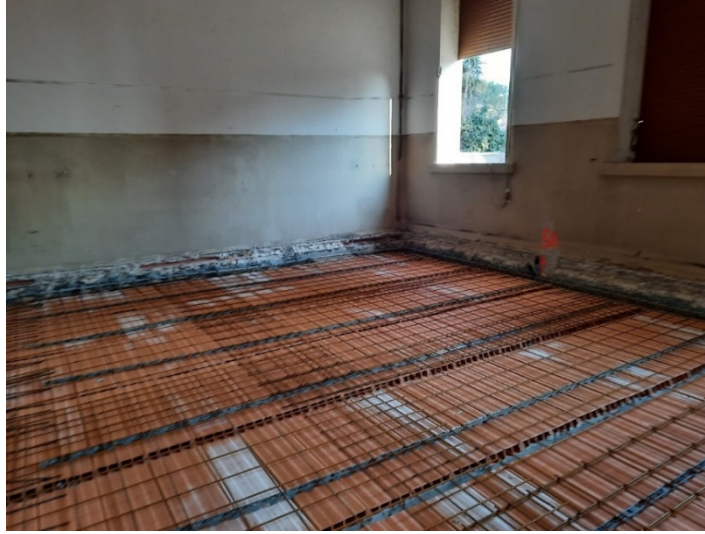
Figura 113 – Solaio in tavellonato di laterizio con maglie elettrosaldate nell'aula centrale – Piano terra
