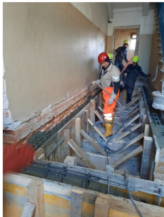
Figura 110 - Getto delle guance in c.a. per il sostegno dell'impalcato in laterizio - Piano terra
