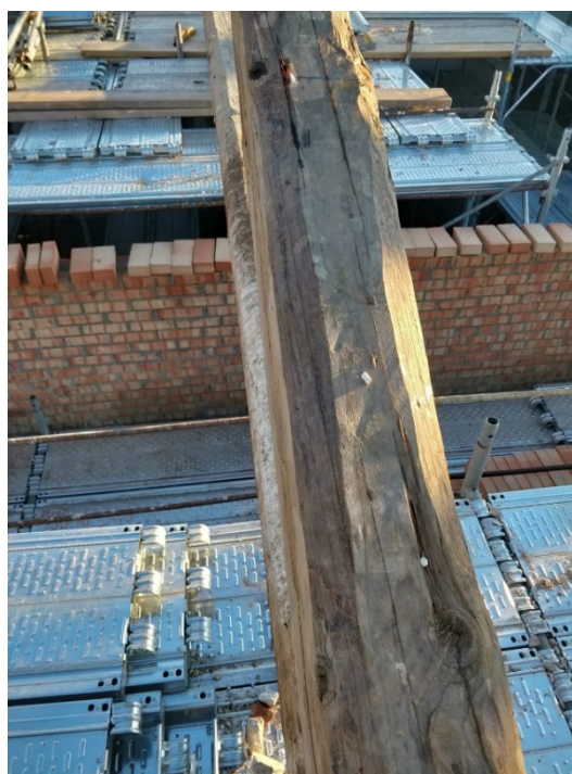
Figura 70 - Stato di conservazione del puntone di una capriata - Copertura
