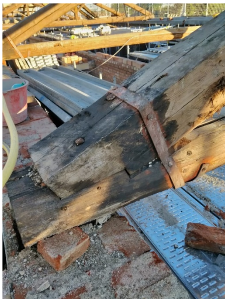
Figura 72 - Stato di conservazione di un collegamento catena-puntone della capriata - Copertura
