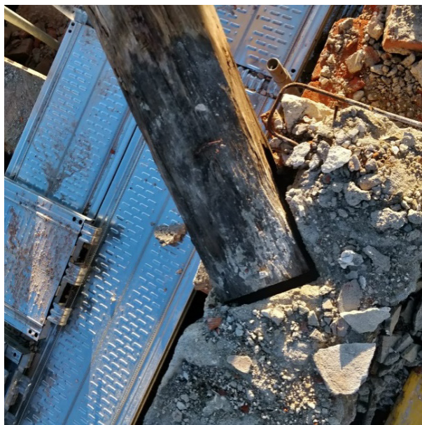
Figura 73 - Stato di conservazione della testa di una trave - Copertura
